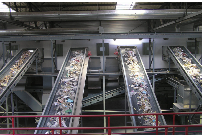
Centre de tri de DIB de Veolia à Ludres (54). La révision de la réglementation sur les décharges pourrait conduire à la multiplication de ce type d'installation.
